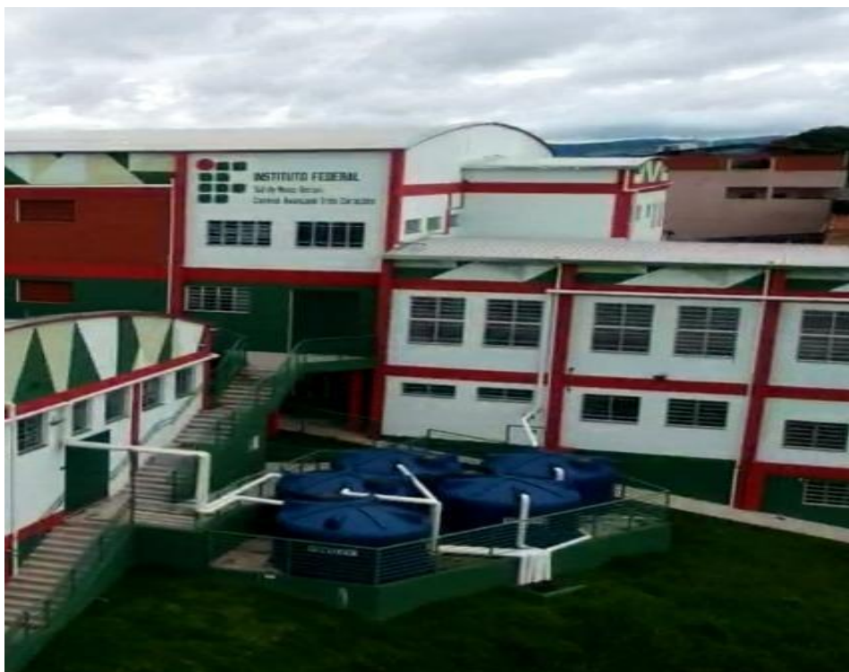
Figura 9 - Estação de coleta de águas pluviais (Campus II). Fonte: Arquivo do Campus
