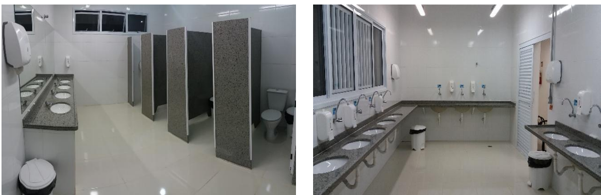
Figura 13 - Sanitários e Barreira Sanitária.
